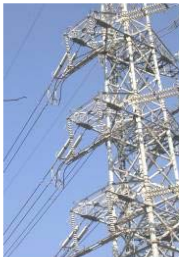
写真 1 2 導体送電線路
