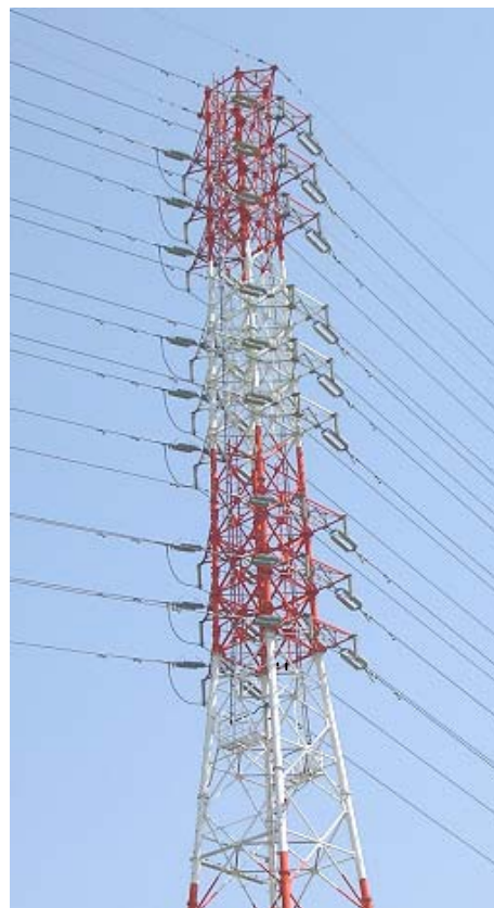
写真 3 多回線電線路(単導線 6 回線)
