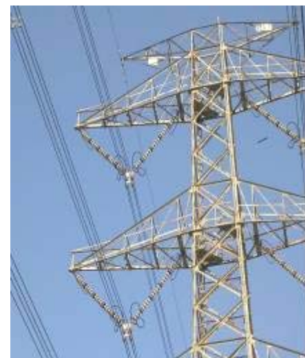
写真 2 4 導体送電線路
