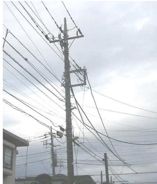
写真 1 街中の配電線柱
