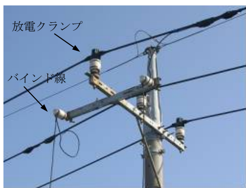
写真2 直線部(放電クランプ)
